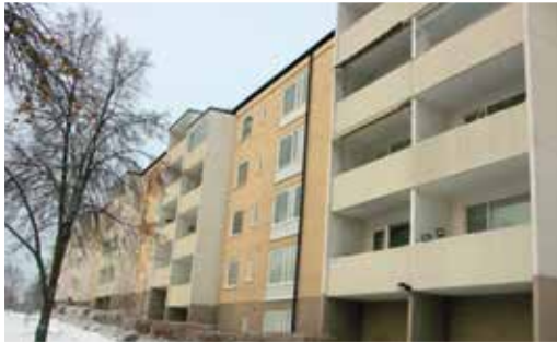
Det er dyrt og tidskrævende at udføre traditionel renovering af åbne altaner, og det skal gøres ca. hver 15. år.
